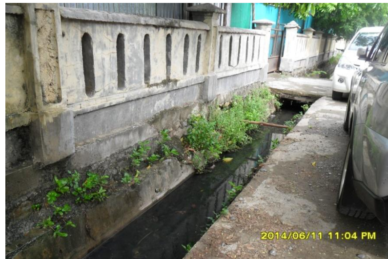
Gambar 3. Kondisi Fasilitas Umum Drainase
