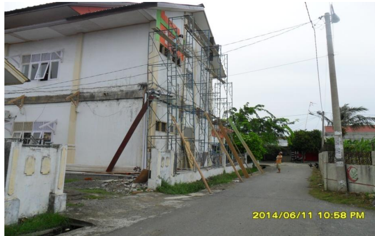
Gambar 6. Kondisi Fasilitas Umum Sekolah
